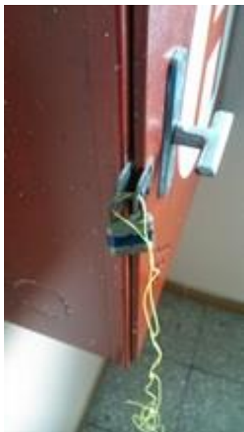
Obr.5. Uzamčená dvířka k hydrantové skříni
