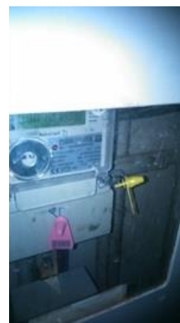
Obr.9. Vnitřek elektrorozvodné skříně s měřiči s elektrické energie
