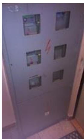
Obr.7. Pohled na elektrorozvodnou skříň
