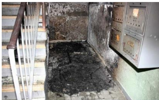
Obr.11. Škody po požáru způsobené na chodbě chráněné únikové cesty po jeho likvidaci
