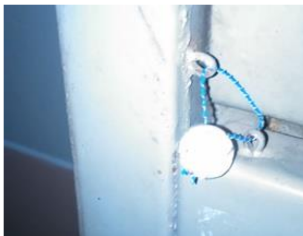
Obr.8. Zaplombovaná vstupní dvířka k elektrorozvodné skříni
