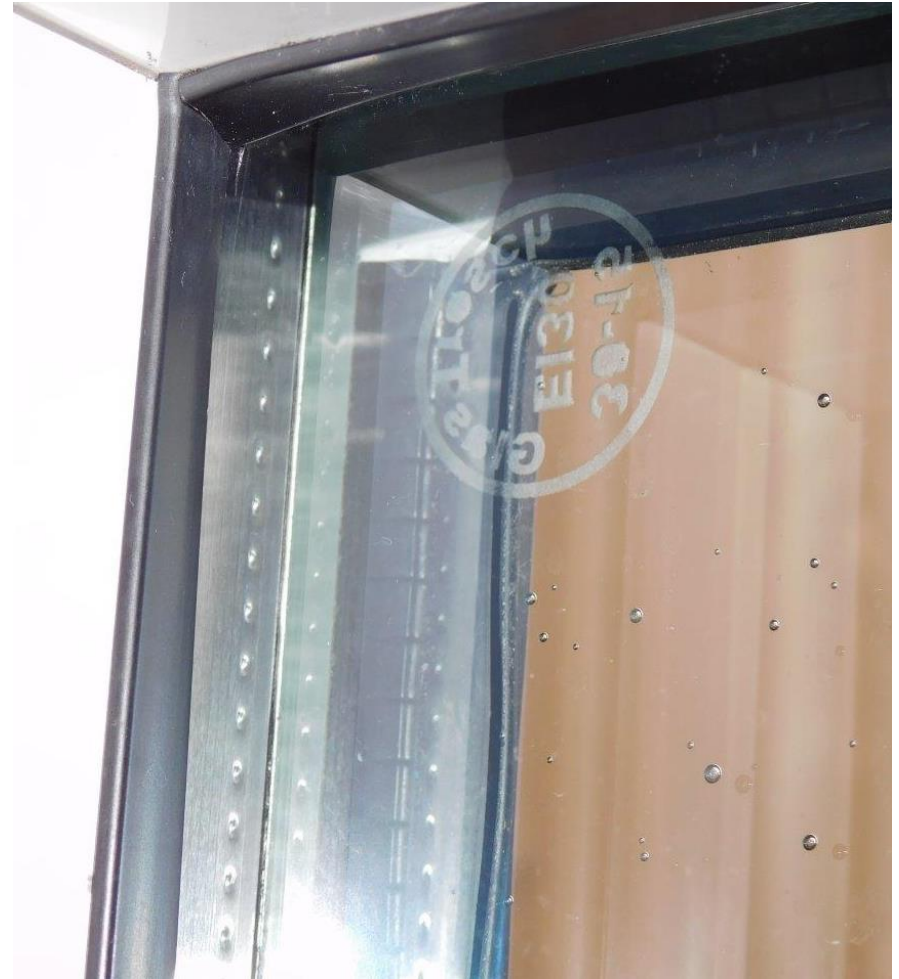
Obrácená značka s označením typu protipožárního skla v rohu tabule
