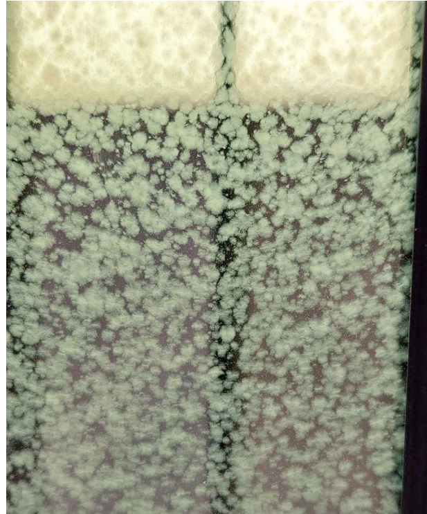
Samostatně se vyskytující fleky ve tvaru sněhových vloček v ploše okna
