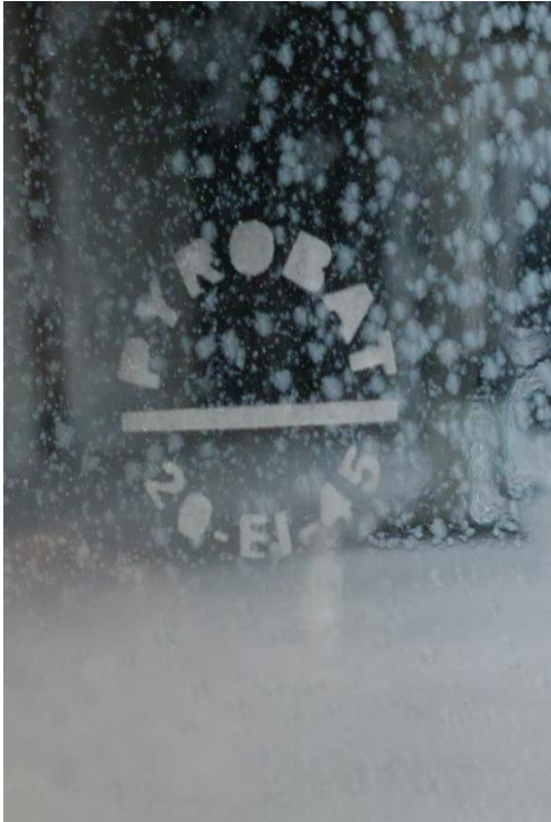
Detail značky výrobce protipožárních oken v rohu okna
