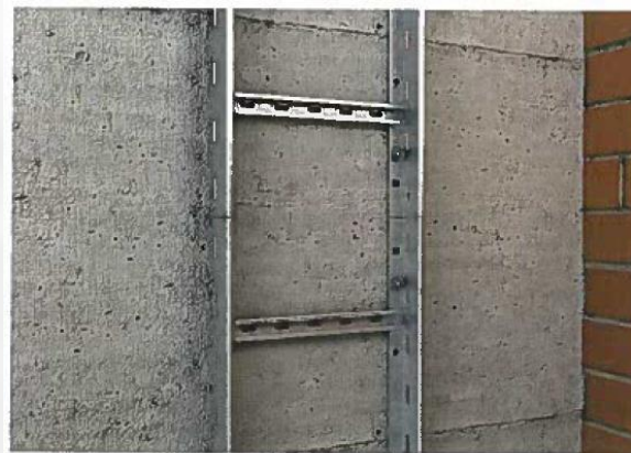
Obrázek C.4 – Kabelový rošt ve stoupací trase
